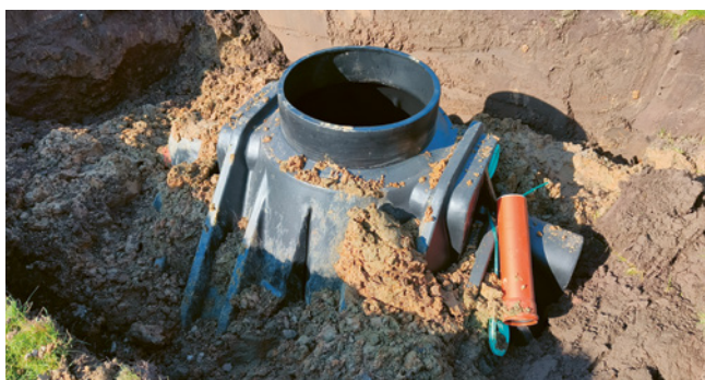
Eerste collectieve IBA in de Feuselsdreef, geplaatst in opdracht van de gemeente via Riopact.
