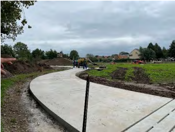
Aanleg van de Wandelpromenade doorheen het nieuwe parkje in het zuiden van de site, met centraal het nieuwe Speellandschap reeds in aanbouw.
